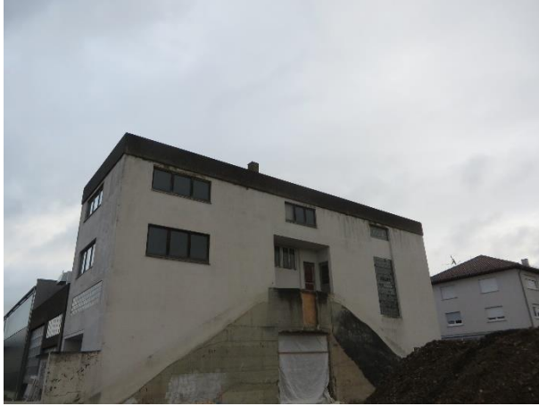
Foto 1: Gebäude mit Fassadenschäden auf Flurstück 1468
