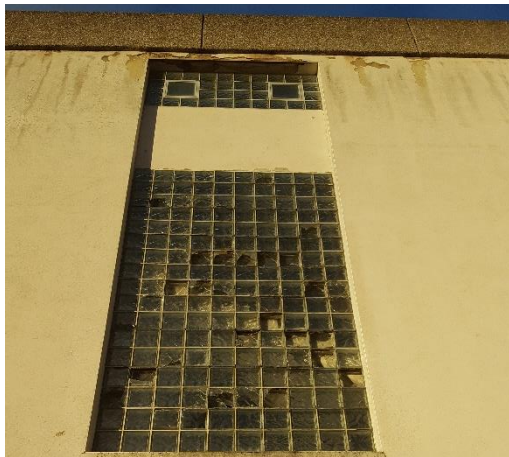
Foto 3: Kaputte Glasbausteine an Fenster des ungenutzten Gebäudes
