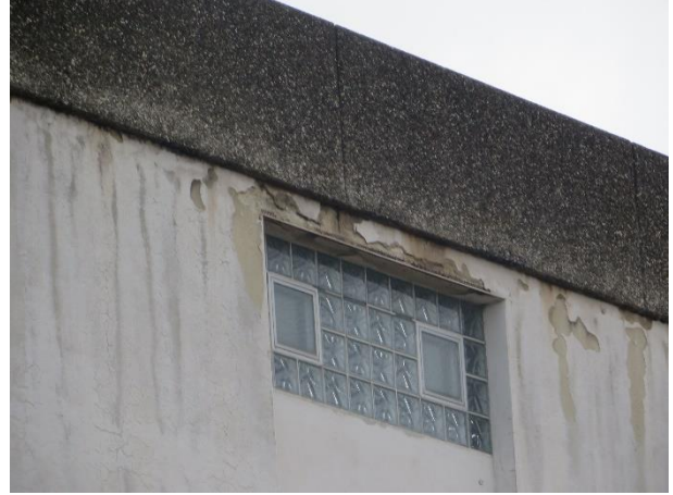
Foto 2: Spalten an geschädigter Fassade, mögliche Tagesverstecke für Fledermäuse
